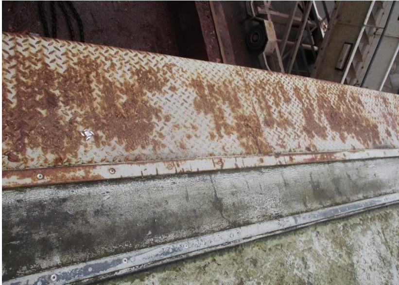
Foto Nr. 62, korrodierte Flap und Befestigungsschiene sowie verschlissene Stolperabdeckung
