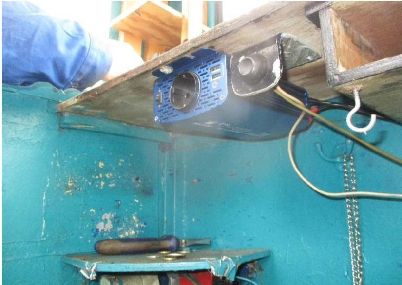
Foto Nr. 85, Wechselrichter für Wechselspannungsgeräte mit geringer Leistung
