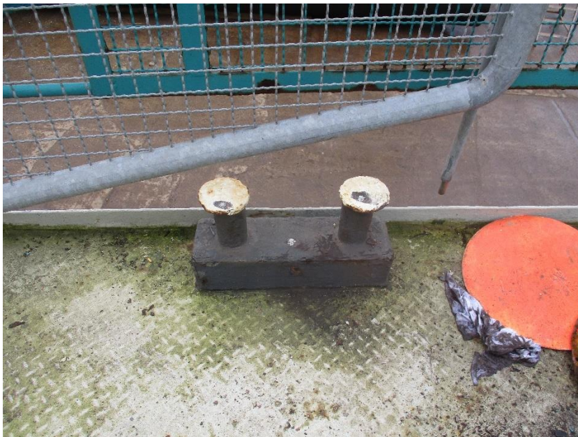
Foto Nr. 64, Pollerbank mit schuppig durchbrechendem Rost
