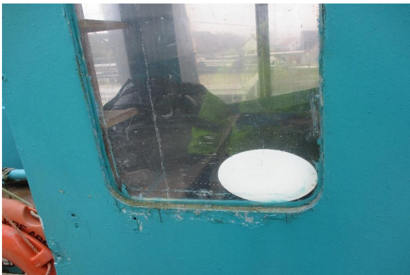
Foto Nr. 71, eingetrübtes Brückentürfenster in sich auflösender Holztür
