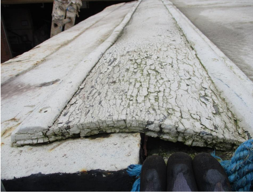
Foto Nr. 29, verschlissene Spaltabdeckung (Stolperschutz) zwischen Rampe und Flap
