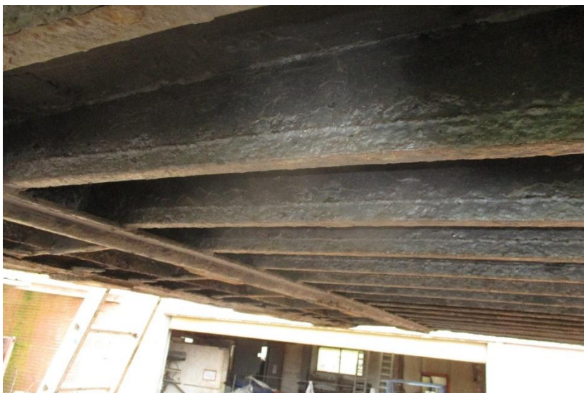
Foto Nr. 18, schiffsseitiges Rampenelement am Bug mit erkennbarer Korrosion aufgrund eines defekten Coatingsystems, jedoch mit ausreichender Restplattenstärke der Unterkonstruktion
