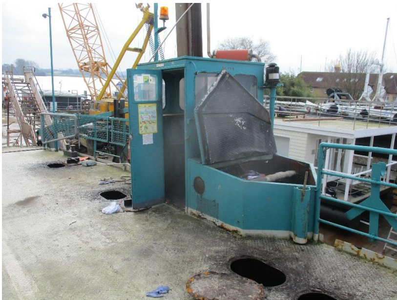
Foto Nr. 65, stark verschlissenes Ruderhaus-Maschinenraum-Ensemble
