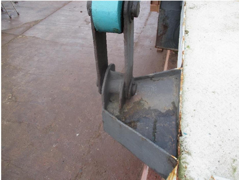
Foto Nr. 42, verrostete Fußleiste und teilweise wegkorrodierte Konsole für Rampenwippe (siehe Fotos Nr. 17 bis 48)
