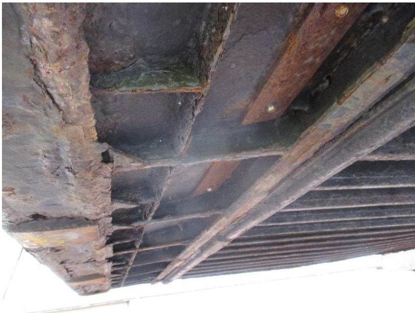
Foto Nr. 28, massive Korrosion an der Unterseite der Rampenflap
