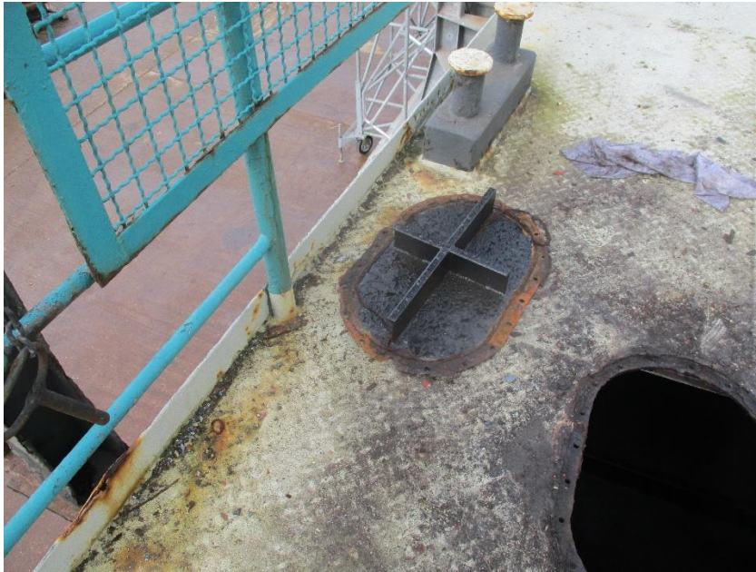
Foto Nr. 56, stark korrodierter Mannlochdeckel mit teilweise erheblichen Materialverlust (siehe Fotos Nr. 34 bis 41 und 49 bis 64)
