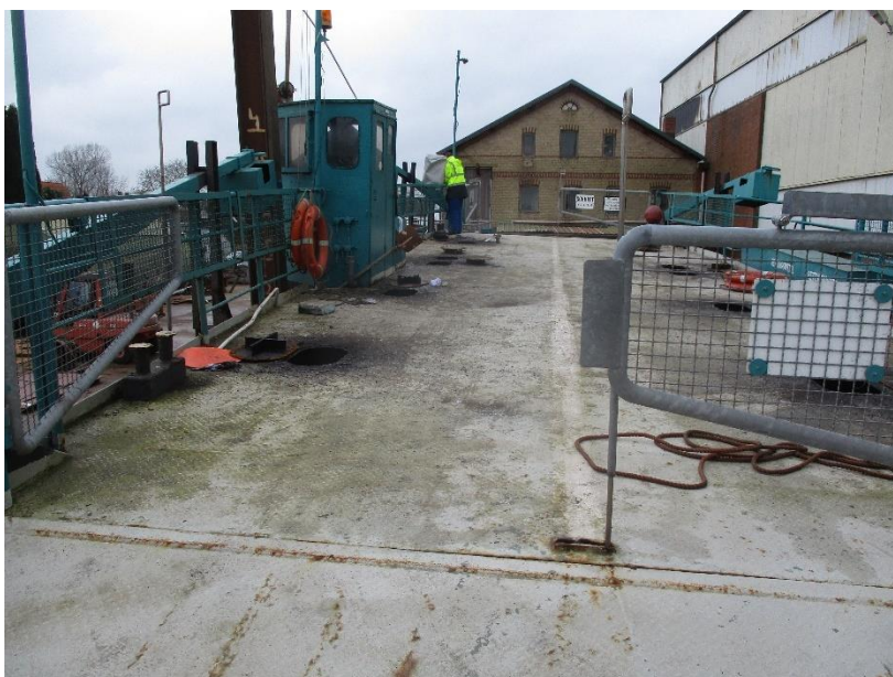
Foto Nr. 49, verschlissenes und unansehnliches Fahrzeug- und Passagierdeck
