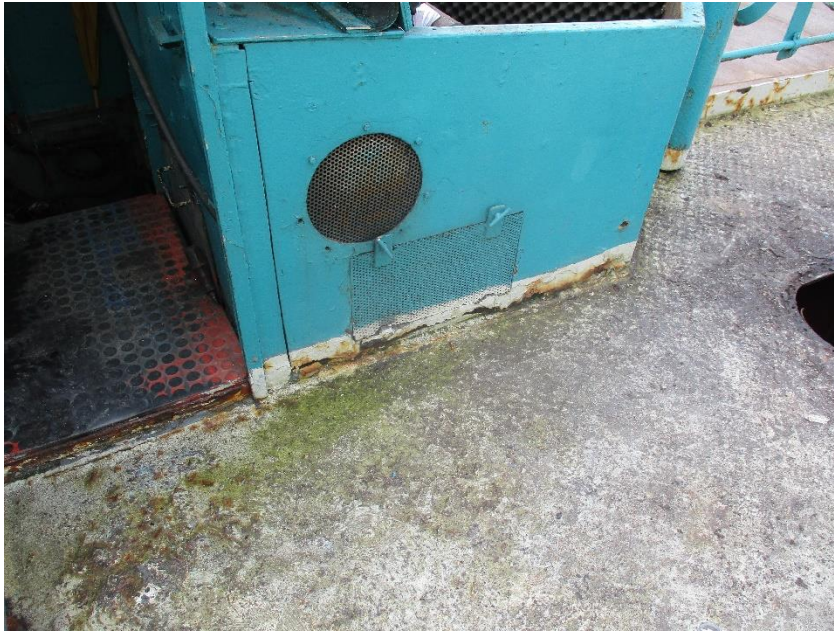
Foto Nr. 66, abgerostete Schottwand des Maschinenraumes auf dem Fahrbahndeck
