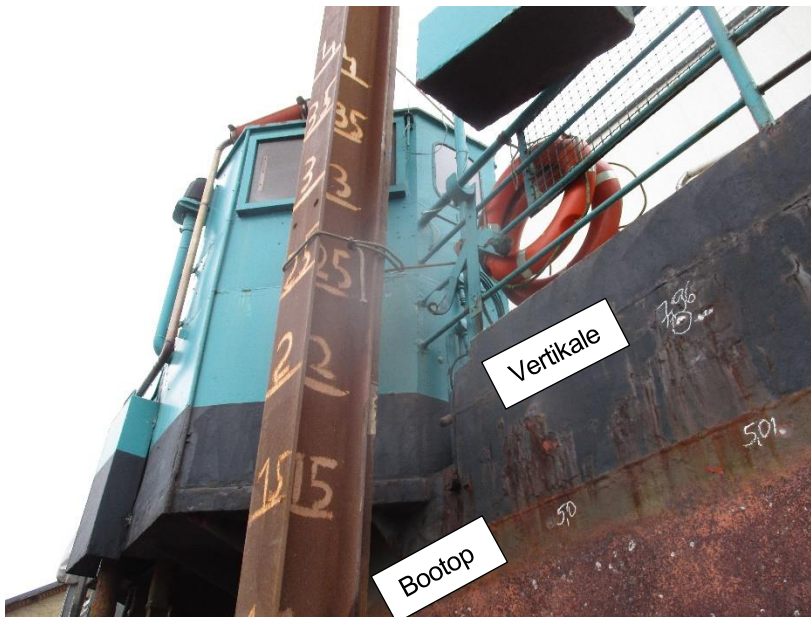
Foto Nr. 12, starke Korrosion im Bootop-Bereich sowie an den Vertikalen
