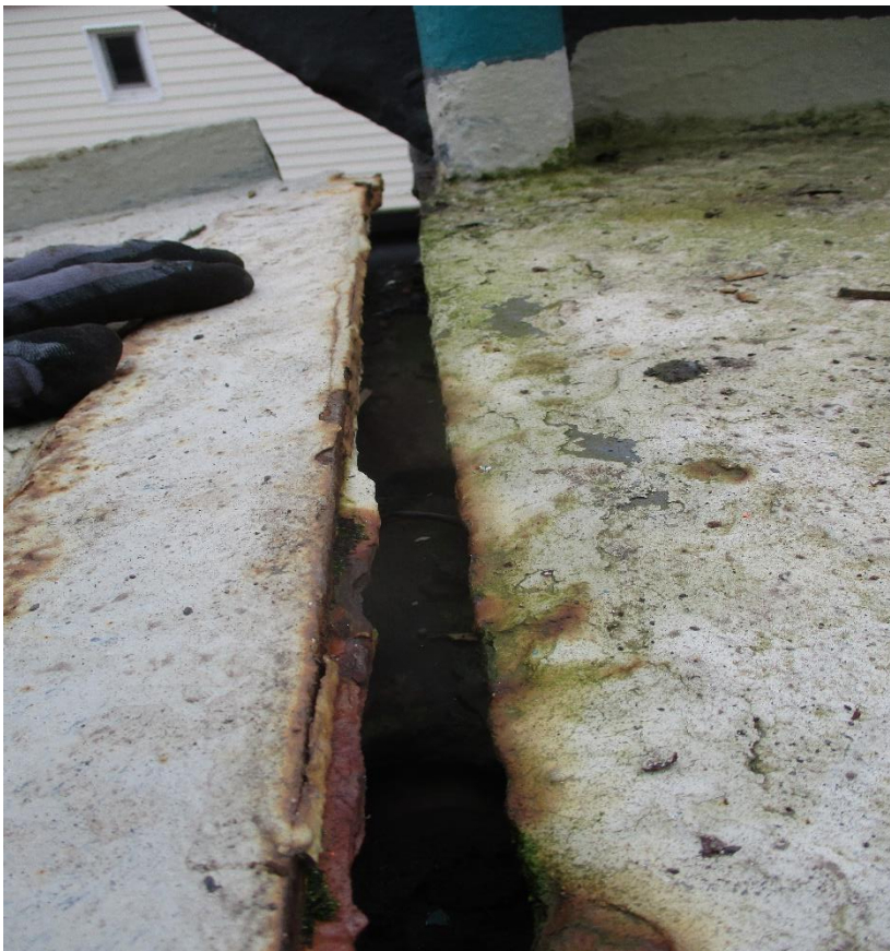
Foto Nr. 35, verrostete und ausgeschlagene Rampenscharniere
