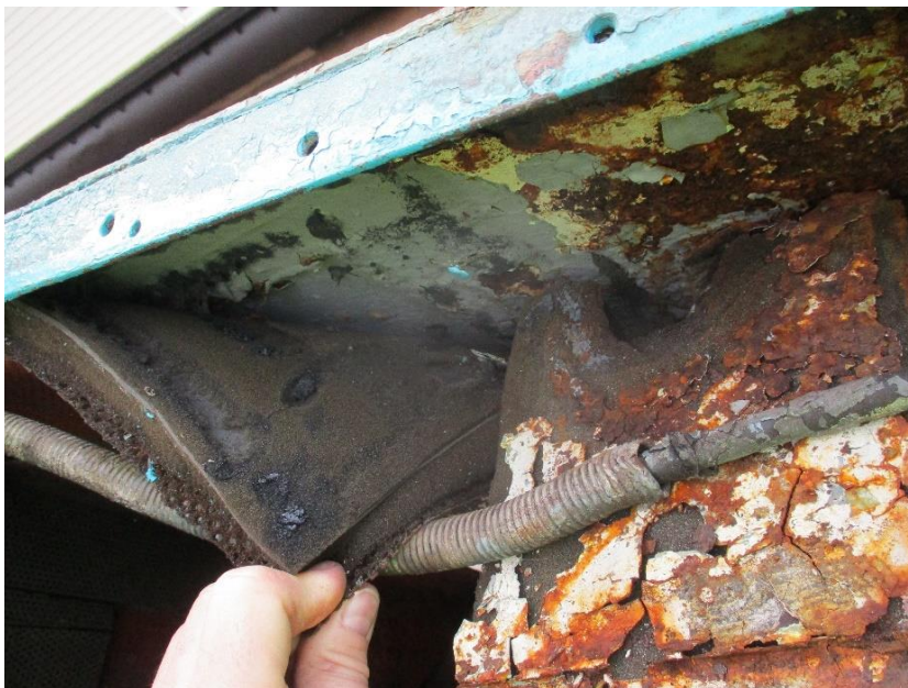
Foto Nr. 92, sich von verrosteten Maschinenrauminnenwände ablösende Schallisolierung
