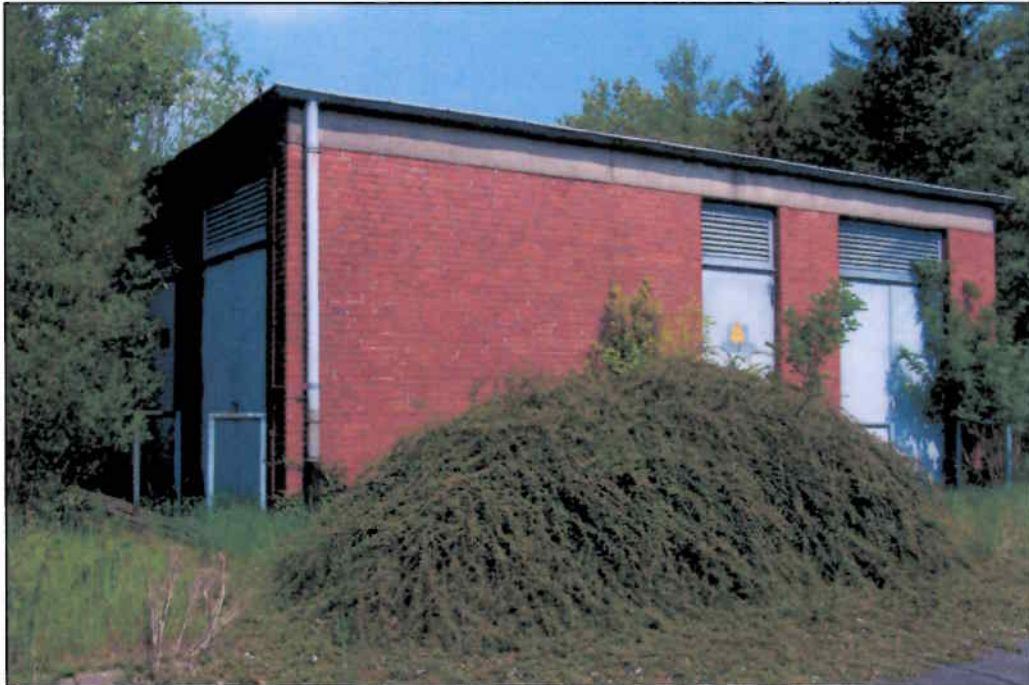
KVF 3: Trafostation, Gebäude 23, Südseite
