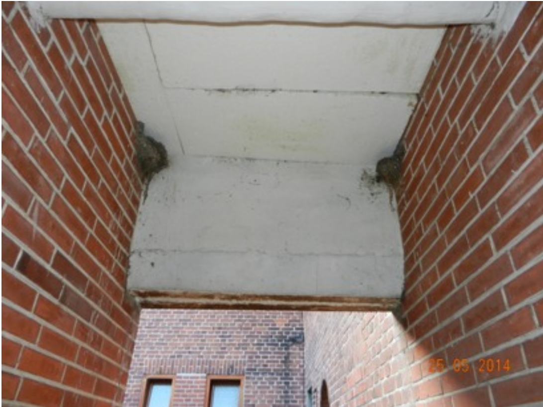
2 Rauchschwabennester Bereich Durchgang Büro > Lange Str. 10
